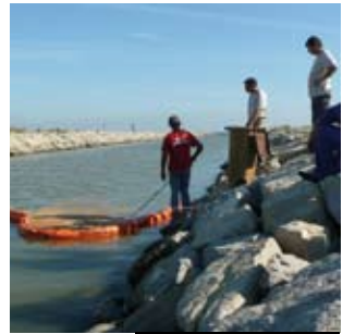
Protection contre les pollutions
